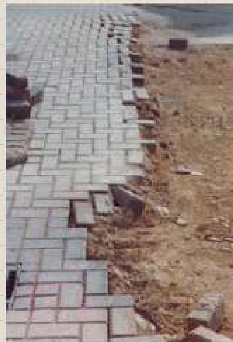
Et graverende eksempel på manglende kantavslutning.
