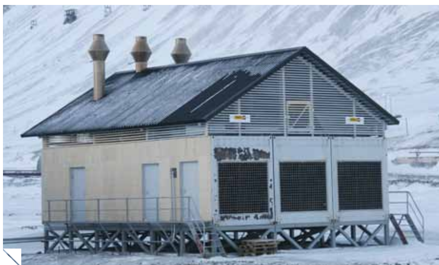
I 2008 ble det levert og montert nytt reservekraftanlegg i Longyearbyen. Foto: Jørn Myrlund
