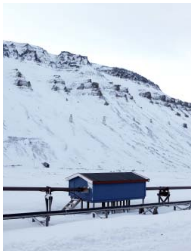
Ekspansjonshus på primærnettet for fjernvarme.
