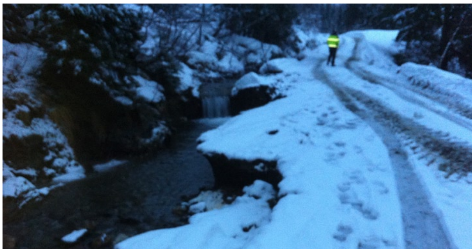
Desember var en måned med store værmessige utfordringer. Deler av Svalengsvegen ble betydelig skadet etter store nedbørmengder
