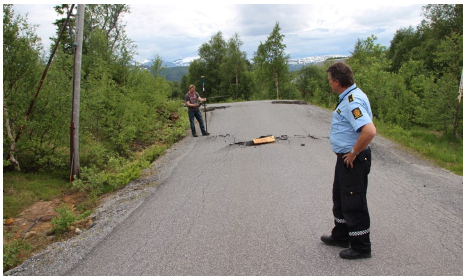
I 2013 fikk en setninger over gruvegangene i Bleikvasslia. Blant annet vegen opp til gruveområdet fikk betydeligs skader
