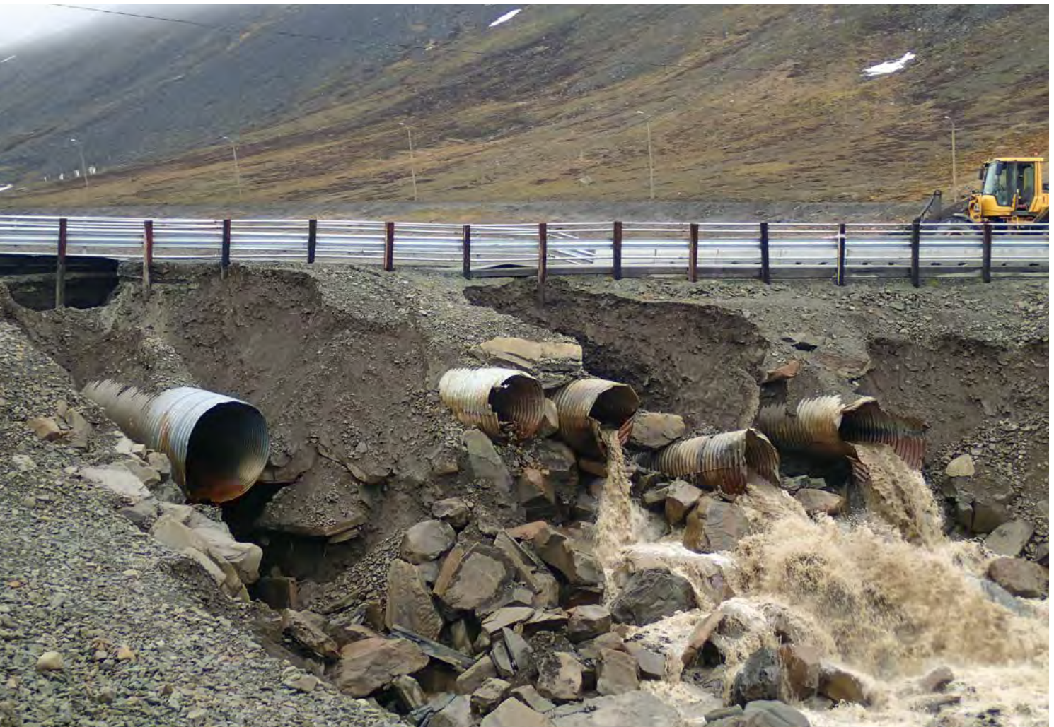
Elvekrysningen av Museumsveien kollapset grunnet en flomstor Longyearelv. Foto: Marianne S. Aasen.
