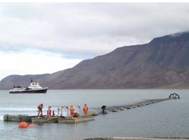
Ny inntaksløsning til energiverket. Foto: Marianne S. Aasen
