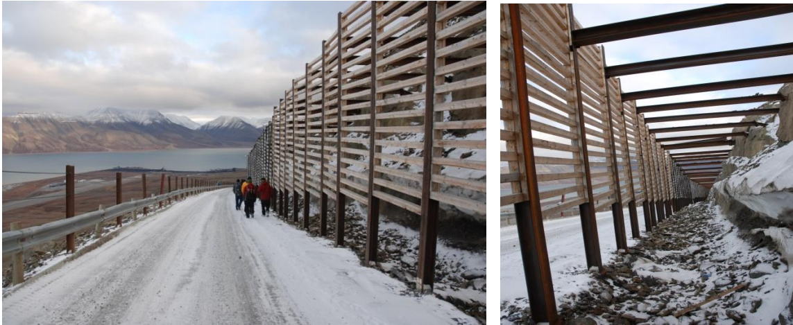
Figur 58. Skredsikring av vegen til SVALSAT med et gjerde (for- og bakside) utført som en stål-tømmer konstruksjon forankret i fjell (foto J. O. Larsen).
