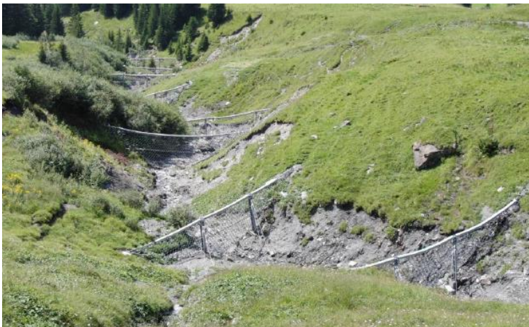
Figur 54. Nett brukt som sikring mot flomskred (Corinna Wendeler, Gebrugg AG, 2013).
