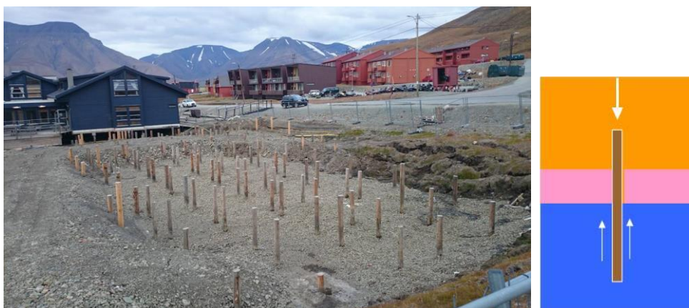
Figur 5. Trepeler av 10 m lengde som fundament i «Svalbard Hotell og Lodge», ferdigbygd 2015. (Foto J. O. Larsen)
