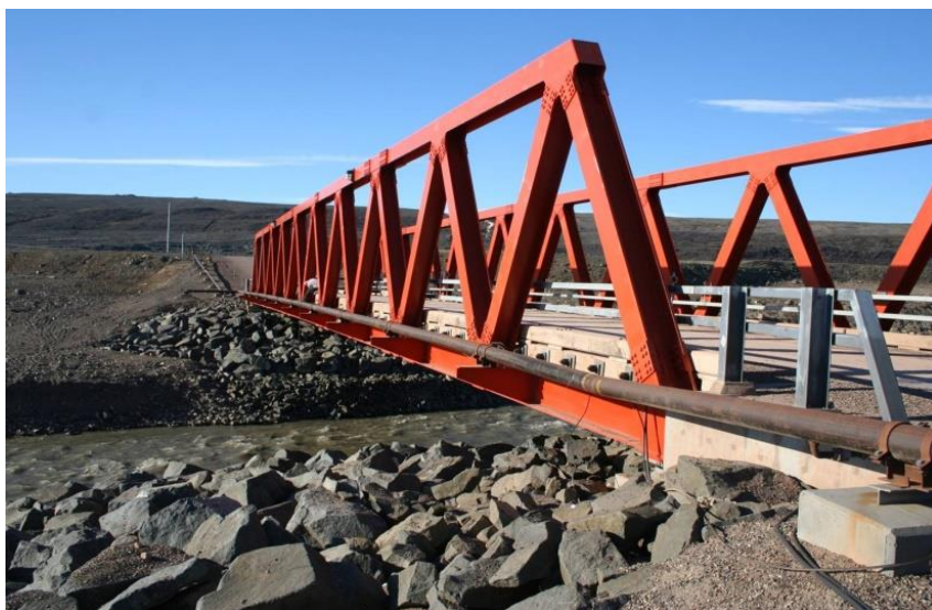
Figur 21. Erosjonssikret brufundament på «Thule Airbase», Grønland (foto J. O. Larsen).
