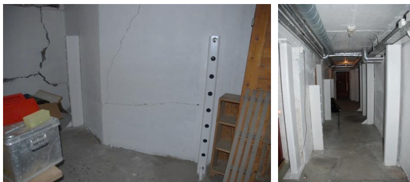
Figur 8. Sysselmannsgården på Svalbard er forsterket med stålpeler og stålrammer både inne i kjeller og ute etter store setninger og skader som følge av uisolert tradisjonell fundamentering på permafrost (foto J. O. Larsen).
