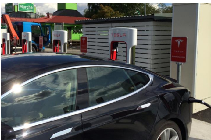
Figur 5 Klimabygg, fordelingsskap og ladestolper sett forfra
