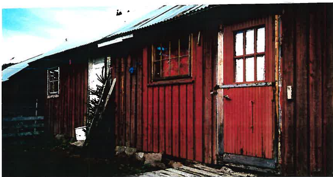
Fig. 20: Bygn. nr.24, bakside. Etter nedleggelsen av stallen periodevis brukt som kiosk. Innsetting av stort vindu og dør med glass bryter med karakteren.
