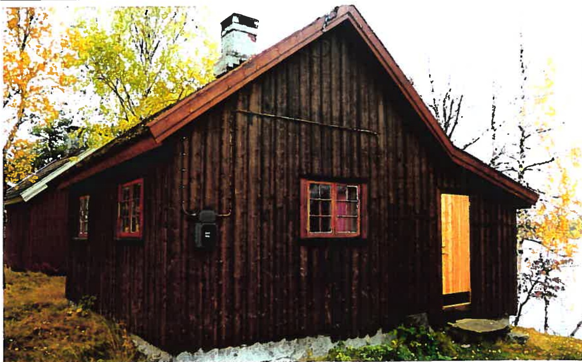
Fig. 13: Bygning nr. 8, ei hytte som er typisk i rekken (som nr. 7 og 14). Innbygging av veranda forandrer bygningskroppen her for mye. Fargesetting og bruk av dekkbeis er ikke original og virker noe forstyrrende.
