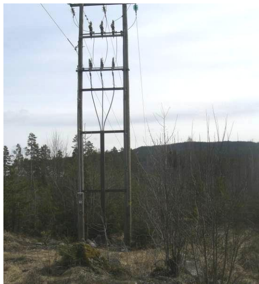
Eksisterende høyspent gjennom området
