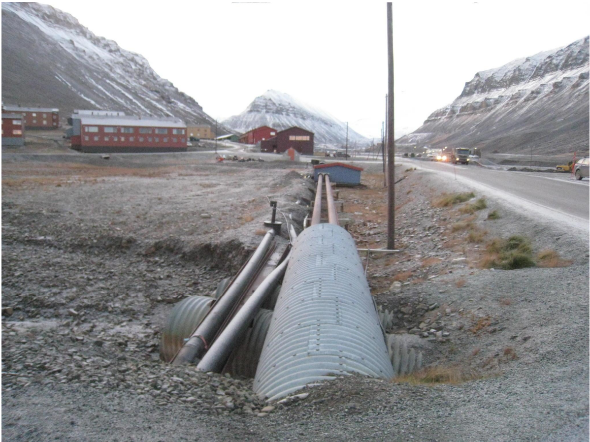
Figur 10: Dagens fjernvarmerør krysser Vannledningsdalen
