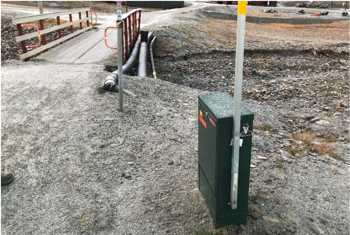
Figur 15: Kabelskap ved Perleporten som må flyttes
