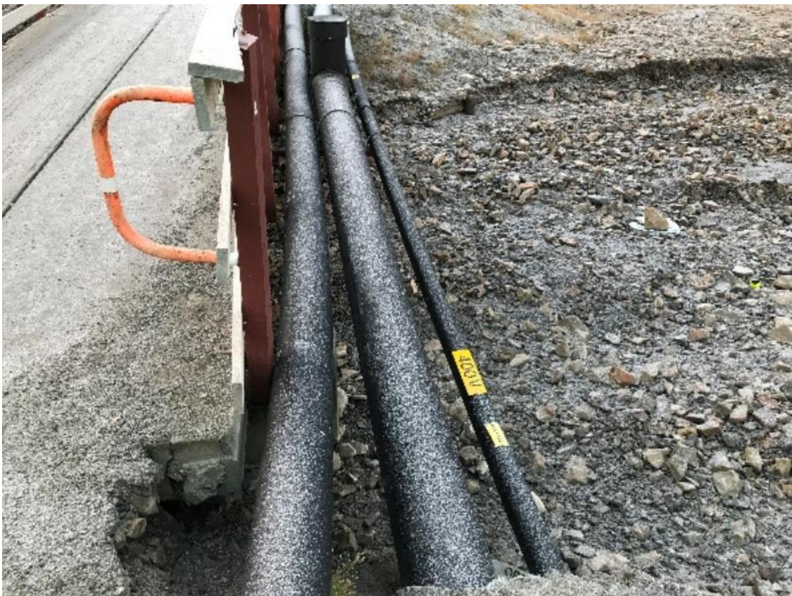
Figur 14: Eksisterende kabel/stikkledning til pumpestasjon
