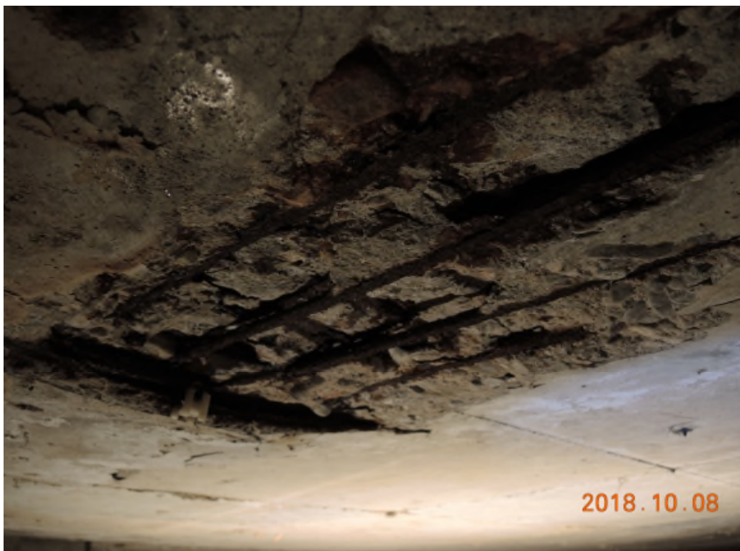
Bilde 2 – Lokasjon L2 UK bassengbunn. Avskallet betong og synlig korrodert armering.
