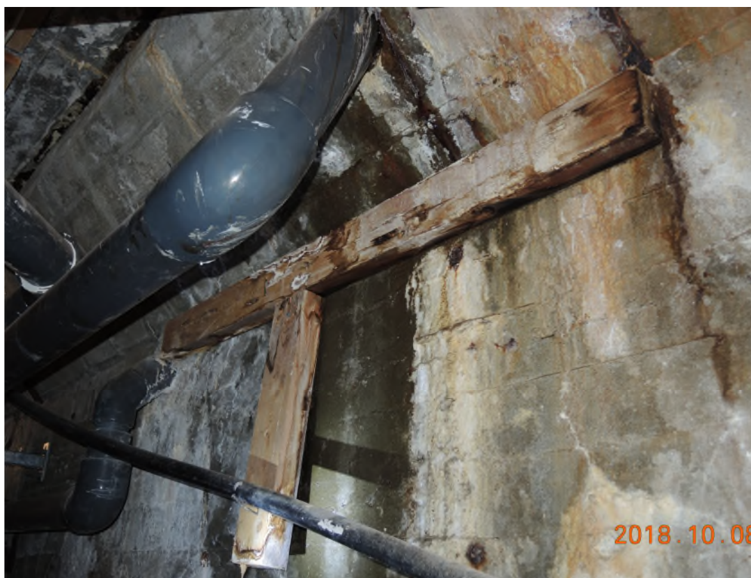
Bilde 6 – Lokasjon L6 bassengvegg VEST Lekkasje rundt avløp fra overløpsrenne, store kalkutfellinger.
