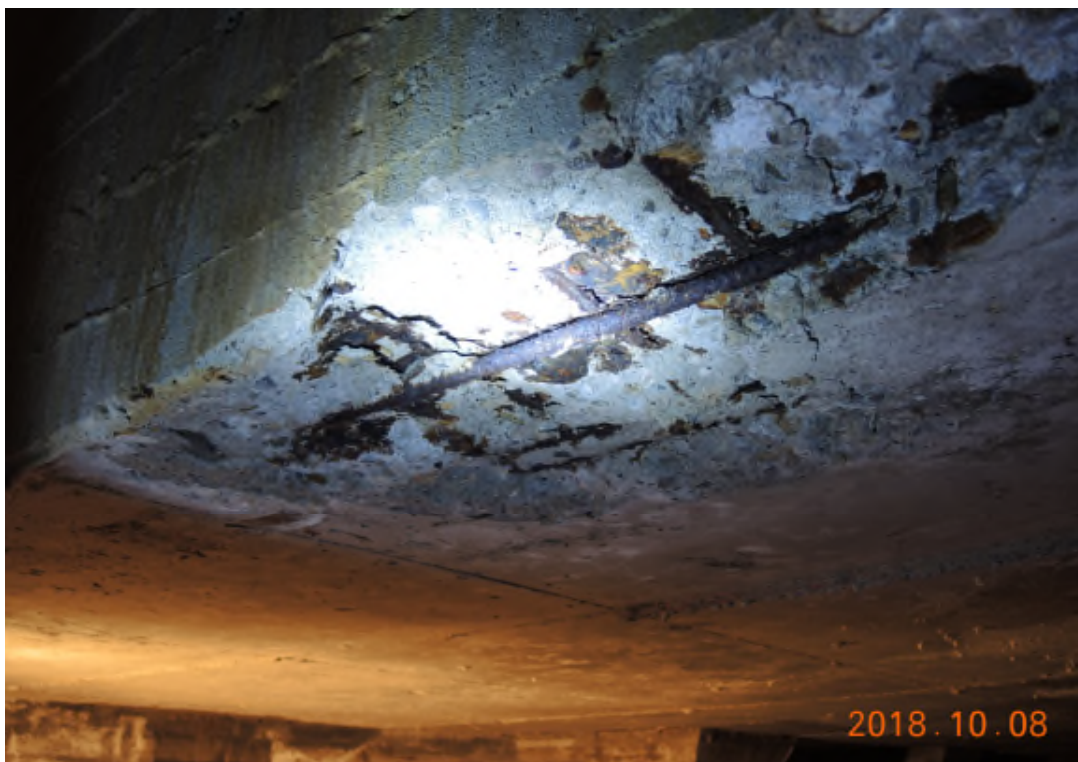
Bilde 5 – Lokasjon L5 UK bassengvegg SØR. Avskallet betong og frilagt korrodert armering
