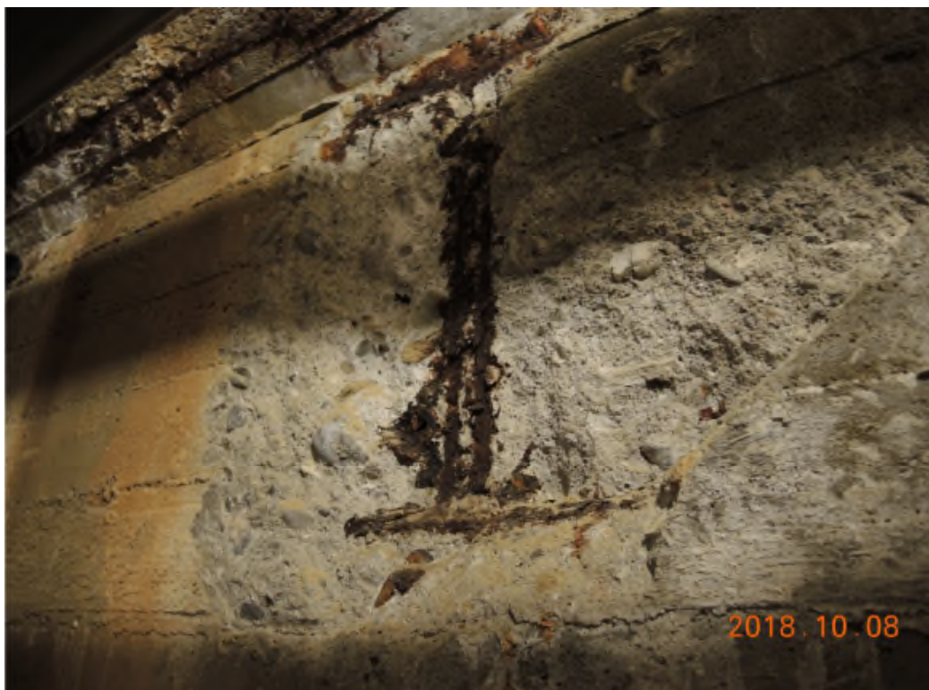
Bilde 1 – Lokasjon L1 Bassengvegg ØST. Avskallet betong og synlig korrodert armering.
