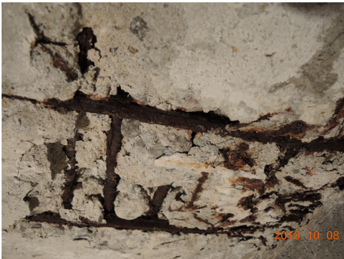
Bilde 3 – Lokasjon L3 UK bassengbunn. Avskallet betong og synlig korrodert armering.
