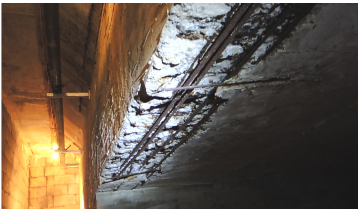
Bilde 4 – Lokasjon L4 UK bassengvegg SØR. Avskallet betong og frilagt korrodert armering
