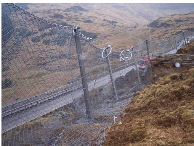
Figur 56. Sikringsnett mot steinsprang og steinskred (Corinna Wendeler, Geobrugg AG, 2013).
