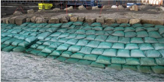
Figur 22. Sandsekker som erosjonsbeskyttelse ved Kapp Amsterdam (foto J. O. Larsen).
