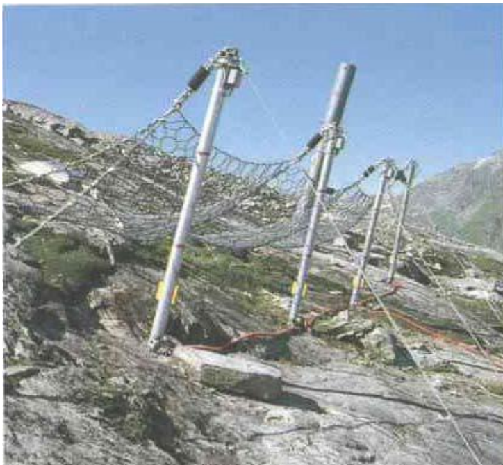
Figur 32. Snønett som sikring i skredløsneområdet. Fra Strynefjellet (foto J. O. Larsen).
