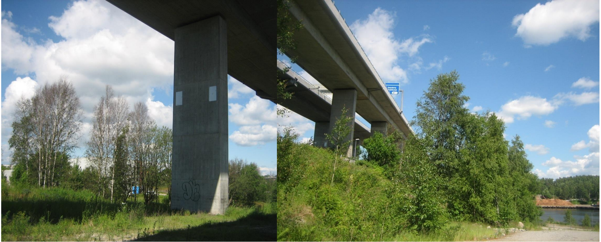
Sandesund bru i Fredrikstad. Skadene er klart størst på sørsiden av E6. Juni 2010.
