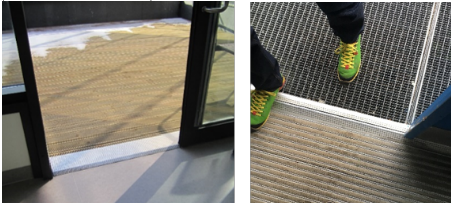
Dører til utearealer med lav ( til venstre) og trinnfri terskel ( til høyre). Foto: Husbanken, Veileder for lokalisering og utforming av omsorgsbygg
